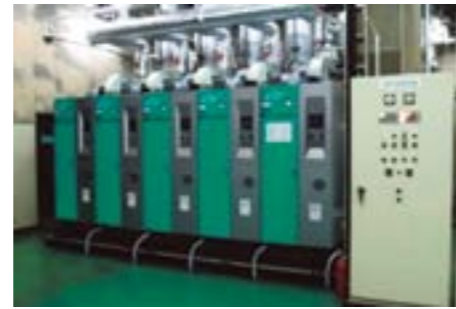
ESCO 事業により導入した 高効率小型貫流ボイラー
